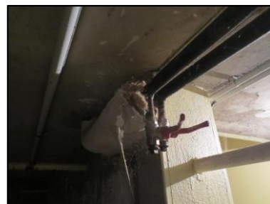
Photo N° 882 ECH-N°2 CALORIFUGEAGE -- DEGAGEMENT -1 Conduits de fluide Laine minérale + enveloppe plâtrée
