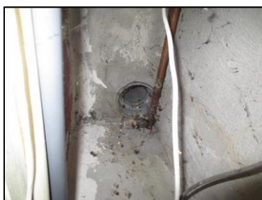
Photo N° 885 AMIANTE CIMENT -- PLACARDS GAZ +2 Gaines & coffres verticaux Ventilation haute (Fibres-ciment)
